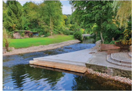
9800-0010 Sohlgleite, Umlenkstufe Bachlauf
